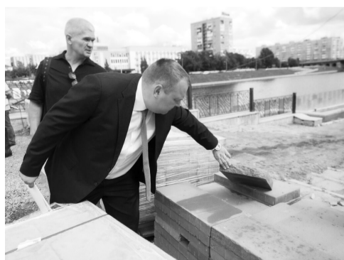
Сергей Кутенёв и некондиционная плитка, которая якобы соответствует ГОСТу
