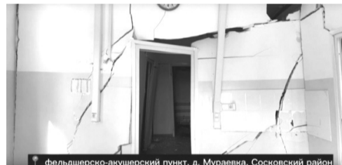
Разрушенный ФАП в селе Мураевка Сосковского района Орловской области
